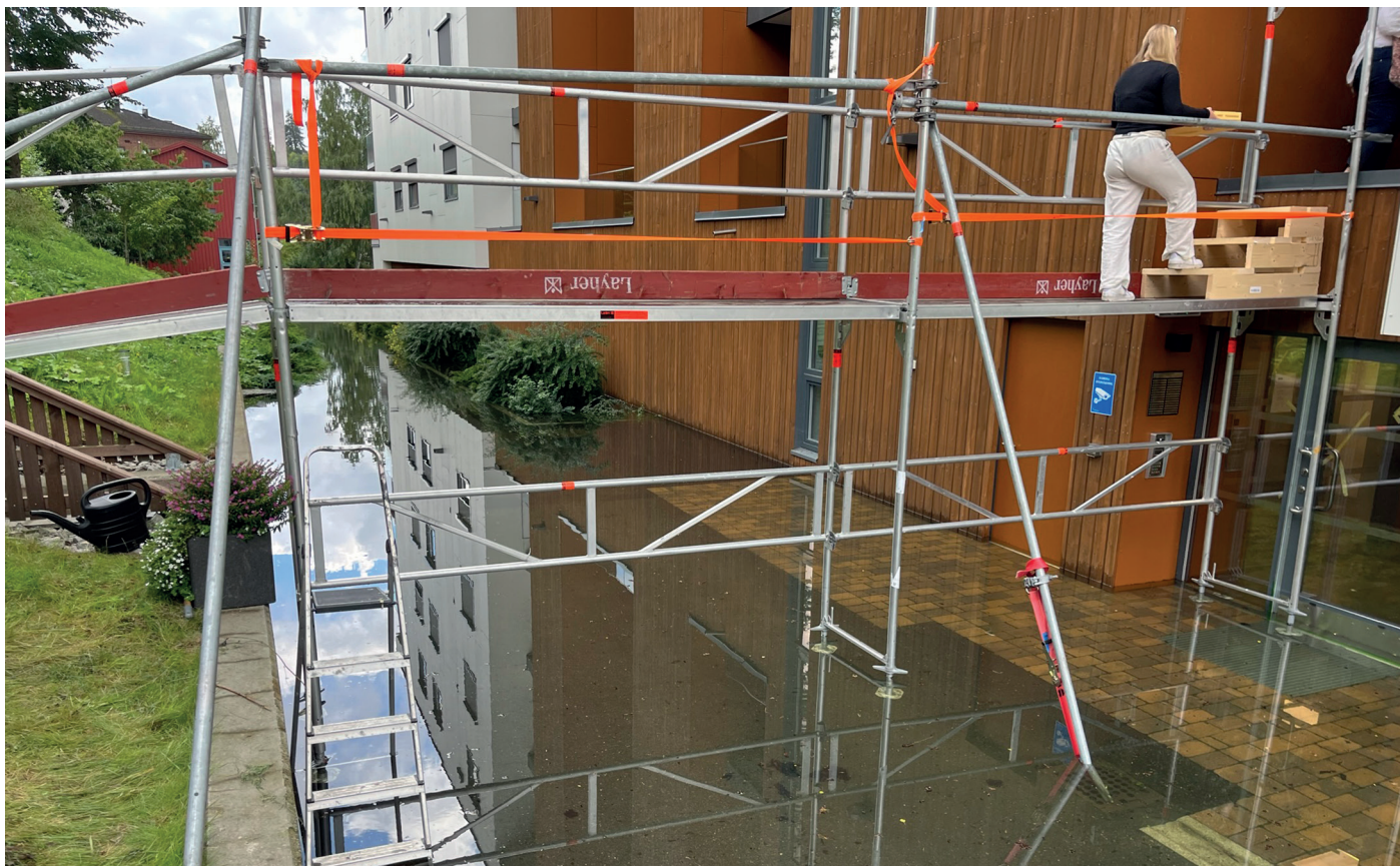
Figur 1: Provisorisk entré i samband med extremvädret Hans.
